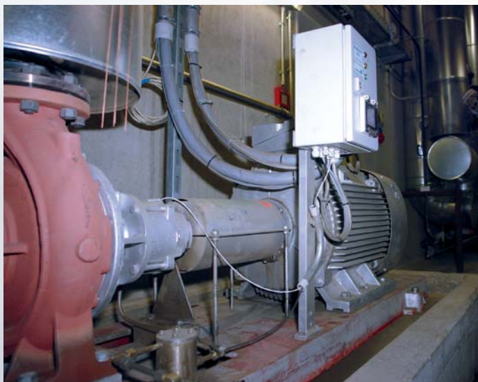
Allheat-Thermalölpumpe mit Allready-Box (weiß) im Biomassekraftwerk. Heizenergie, die nicht für die Trocknung benötigt wird, gibt die Genossenschaft als Fernwärme ab. Die Pumpe fördert Thermalöl (Diphyl THT) mit einem Druck von 8,5 bar und einer max. Förderleistung von 285 m 3 /h.
