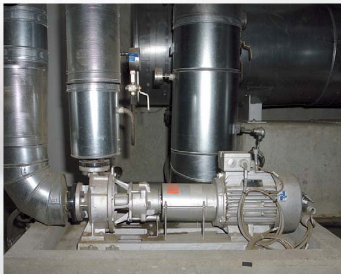
Allweiler-Pumpe aus der Allheat-Serie als Umwälzpumpe für die Notkühlung. Fördermedium synthetisches Thermalöl (Diphyl THT), Förderdruck 3,5 bar, Förderleistung 105 m 3 /h.
